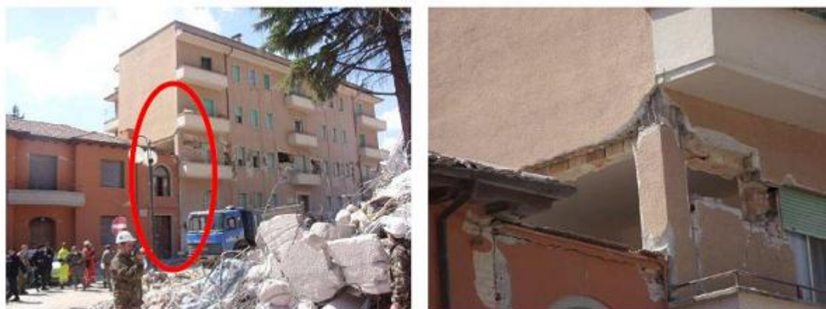
Figura 13 – Contiguità di edifici con caratteristiche geometriche e strutturali differenti (fonte: Decanini 2009)
