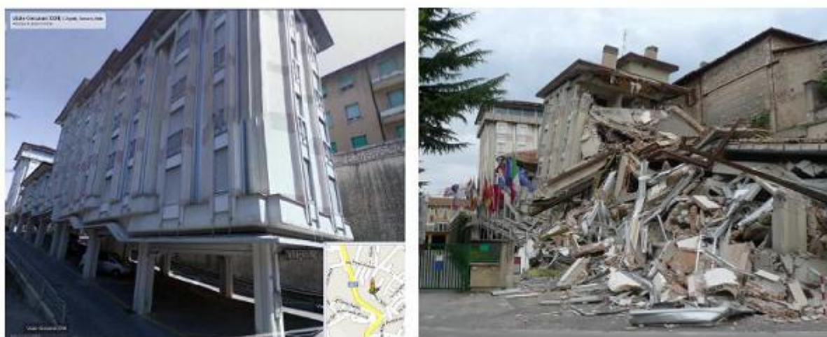
Figura 12 – Esempio di piano debole con irregolarità di forma, struttura e presenza di pendio – Terremoto dell’Aquila 2009
