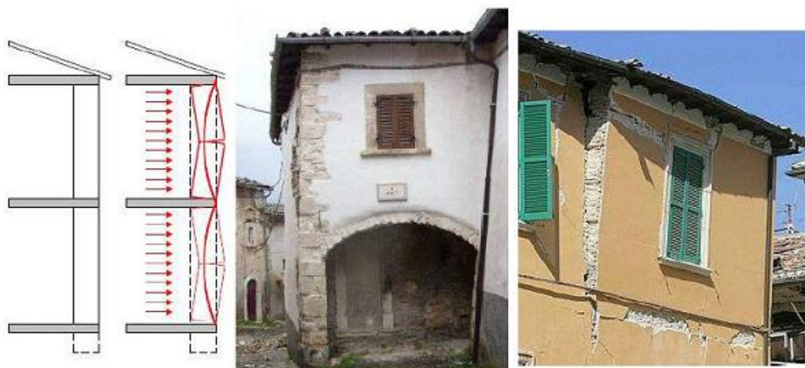
Figura 7 – Danneggiamento di muratura per flessione – Abruzzo 2009 ( fonte: a) b) L. Sorrentino – Governare il rischio, 2012)
