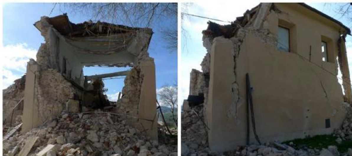
Figura 4 – Collasso di edificio in muratura – Terremoto de L'Aquila 2009
