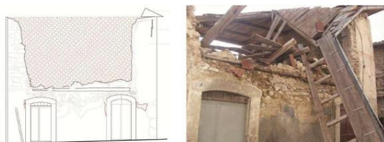
Figura 15 – Esempio di danneggiamento per radicamento ligneo (fonte: Governare il rischio 2012)
