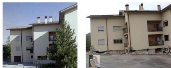
Figura 10 – Esempio di collasso dovuto a cedimento di piano “soffice” - L'Aquila, 2009
