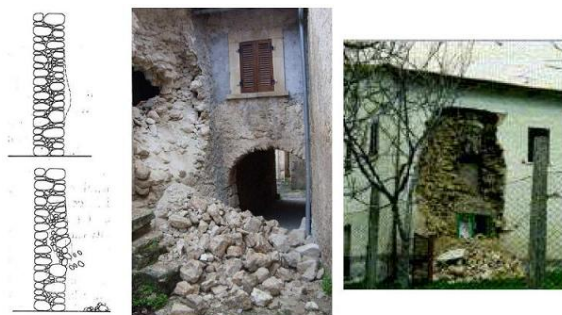
Figura 6 - Danneggiamento di muratura per disgregazione (fonte: a) Giuffrè, 1993; b) Abruzzo 2009 - Governare il rischio, 2012; c) manuale AeDES: Perugia 1996)
