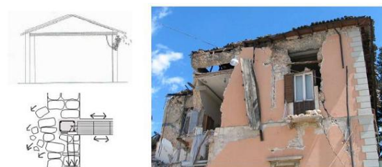
Figura 14 – Abruzzo 2009 – Danneggiamento di muratura in presenza di cordoli in c.a. (fonte: Governare il rischio 2012)
